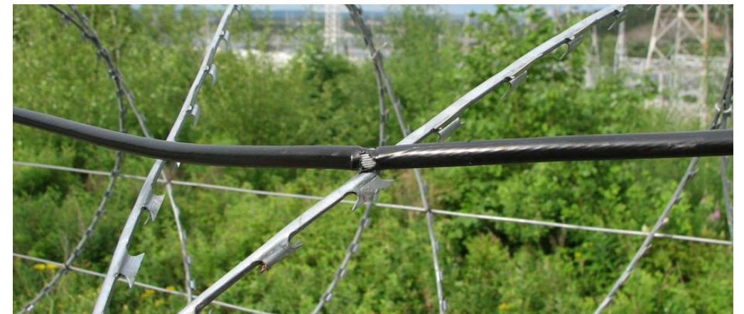
Рис. 8 Повреждение оболочки виброчувствительного кабеля, смонтированного на АКЛ
